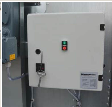
Rozvaděč pro sekvenční spouštění a vypínání motorů – stačí pouze připojit napájecí kabel.
